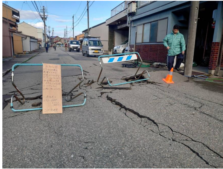
舗装の亀裂、段差
