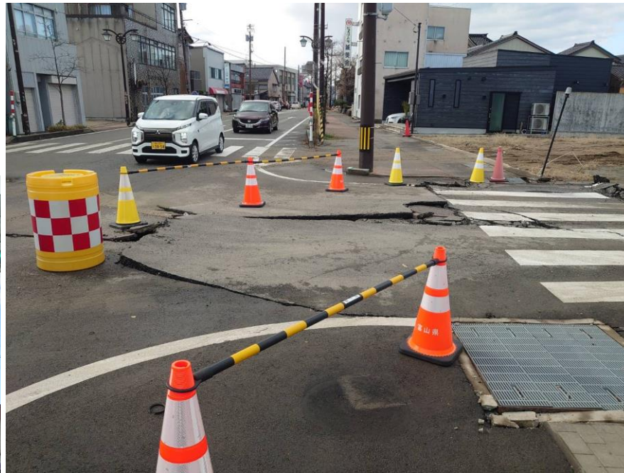
舗装の亀裂、段差
