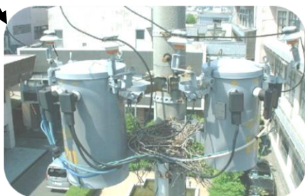
○電柱中間部の変圧器の間
