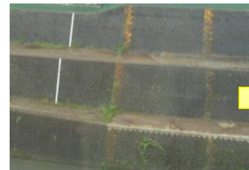
量水標(修繕前)
