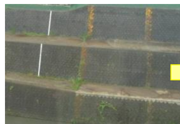
量水標(修繕前)
