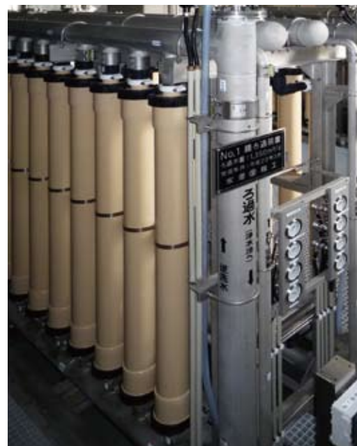
森山浄水場(膜ろ過設備)
