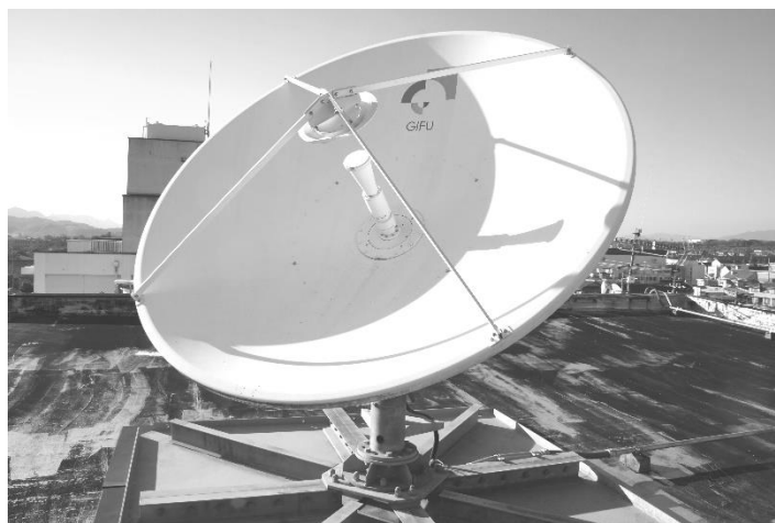
「衛星通信用アンテナ(市役所屋上)」
