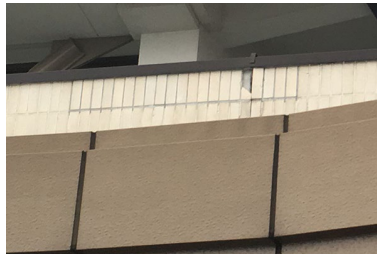
本館外壁タイルの剥がれ
