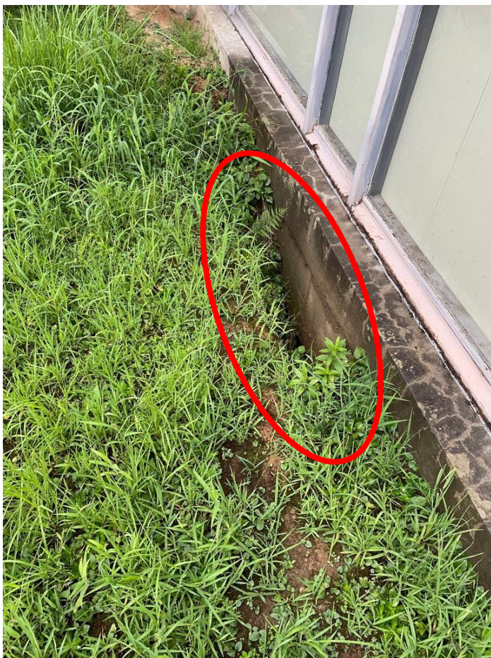
基礎横の地盤との空洞
