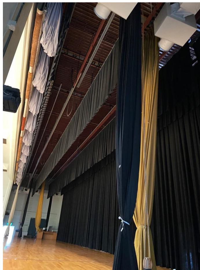
ステージ幕升降機の升降機能の故障
