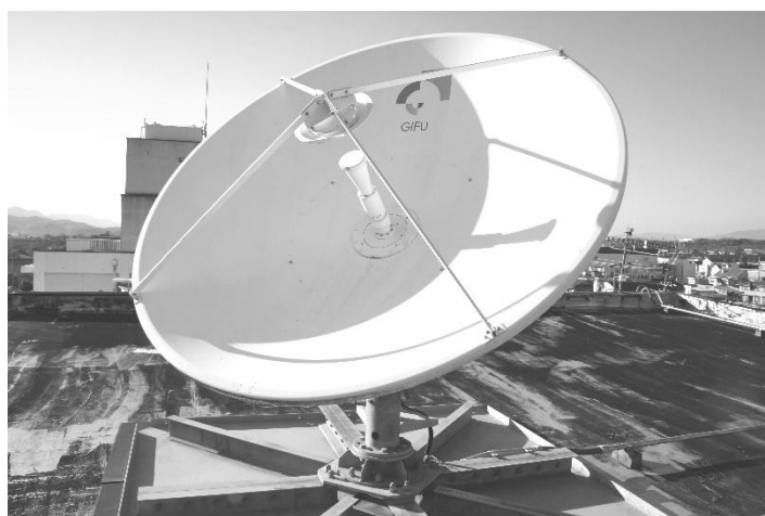
「衛星通信用アンテナ(市役所屋上)」
