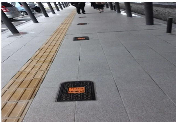
(防災トイレ用マンホール)
