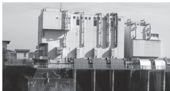
加茂川排水機場
