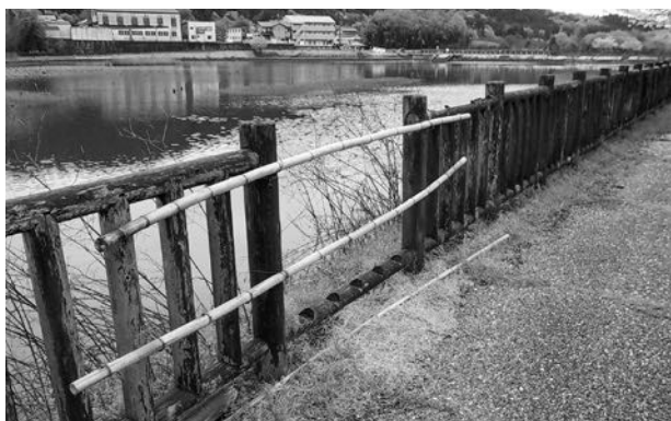
損傷している柵(稲葉池)
