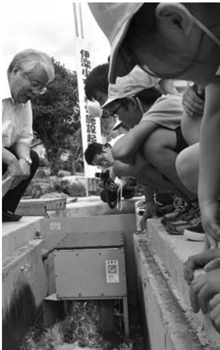
伊深小前の水力発電施設
