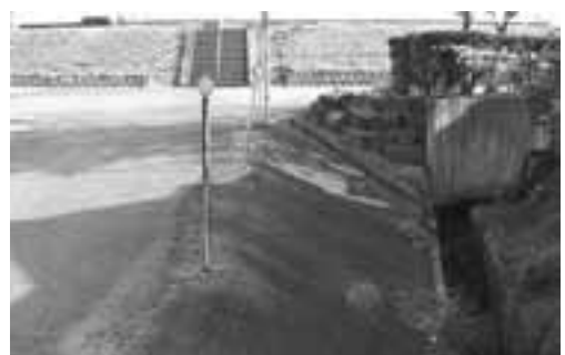
転落の危険性がある道路側溝
