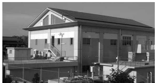
太陽光発電設備が設置されている森山浄水場
