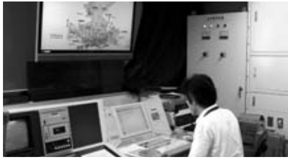
操作卓の更新をした市役所防災無線室
