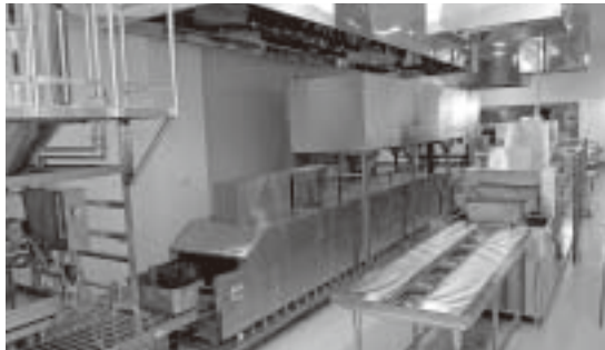
新給食センターの炊飯設備
