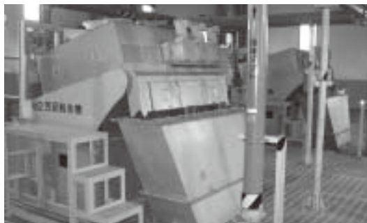
蜂屋川クリーンセンターの汚泥脱水機
